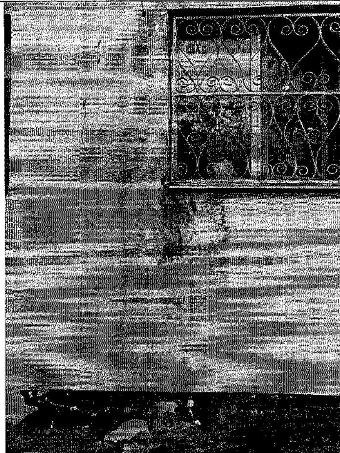
Фото 15. Наружная стена. Локальные следы замачивания и разрушения штукатурного слоя на уровне 1-го этажа.
